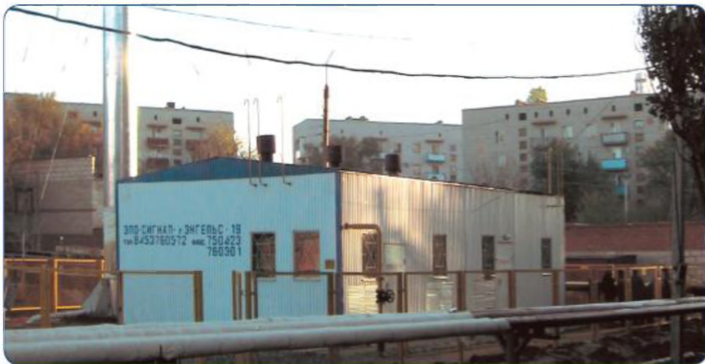
Котельная ТКУ-10. Астраханская область, пос. Красные Баррикады.
